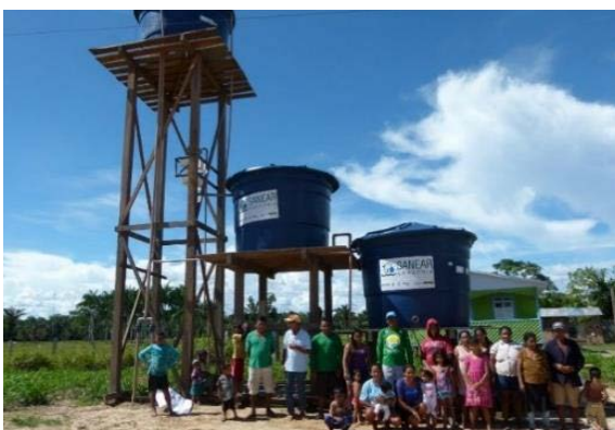
Sistema pluvial multiuso comunitário
